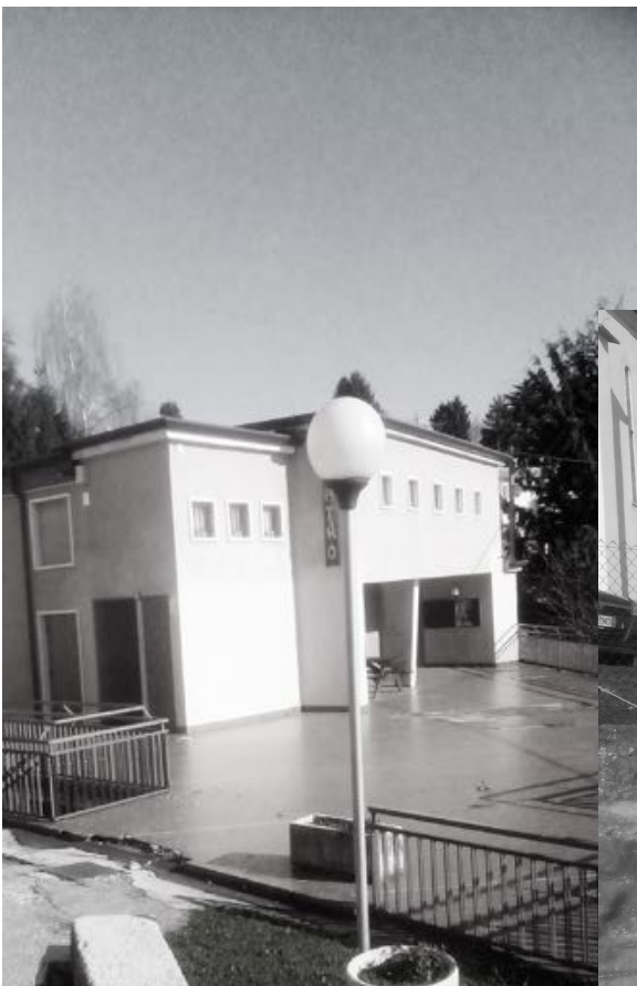
La terrazza davanti al teatro con urgente necessità di interventi.
